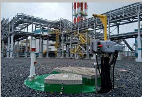
Производство и поставка 30-и комплектных КНС ПАО "СИБУР Холдинг" Западно- Сибирский Нефтехимический комбинат Г. Тобольск
