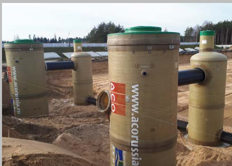
Индустриальный парк "Великий камень" Оборудование для очистки поверхностного стока в составе ЛОС накопительного типа с самым большим в мире безбетонным аккумулярующим резервуаром АСО StormBrixx, Минск, Республика Беларусь
