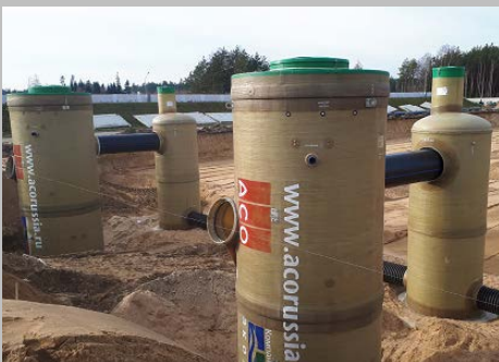
Индустриальный парк "Великий камень" "Оборудование для очистки поверхностного стока в составе ЛОС накопительного типа с самым большим в мире безбетонным аккумулярующим резервуаром АСО StormBrixx, Минск, Республика Беларусь
