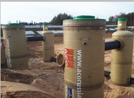
Индустриальный парк "Великий камень" "Оборудование для очистки поверхностного стока в составе ЛОС накопительного типа с самым большим в мире безбетонным аккумулирующим резервуаром АСО StormBrixx, Минск, Республика Беларусь
