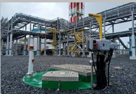
Производство и поставка 30-и комплектных КНС ПАО "СИБУР Холдинг" Западно- Сибирский Нефтехимический комбинат Г. Тобольск
